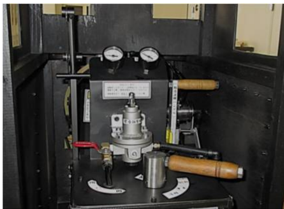
運転操作盤 (マスコンハンドル・逆転ハンドル)
