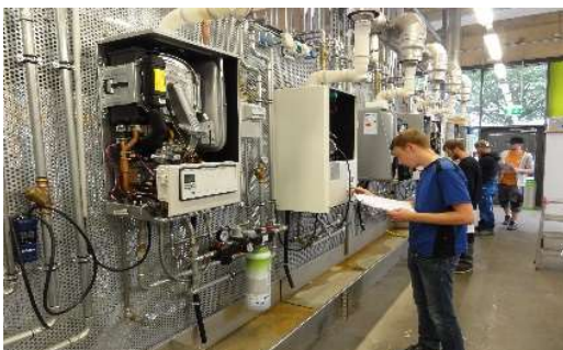
空調設備工事士実習設備
